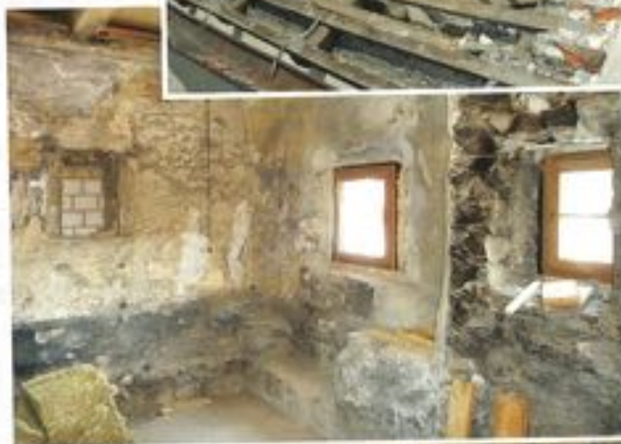
gründlich stabilisiert und saniert werden.
